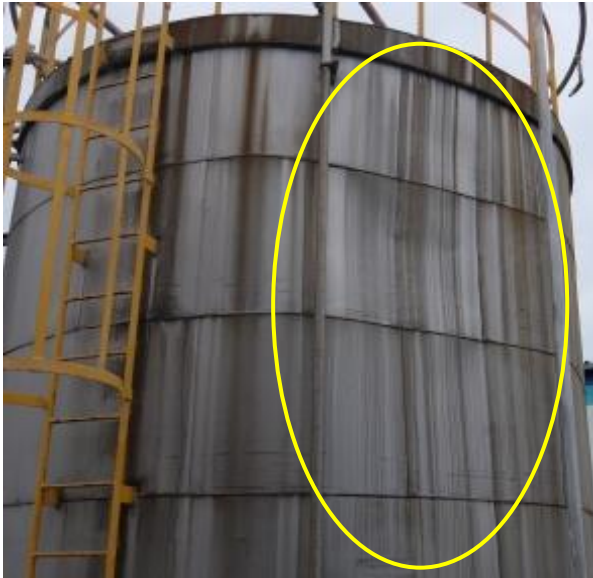
【写真】 シクロヘキサンタンク
