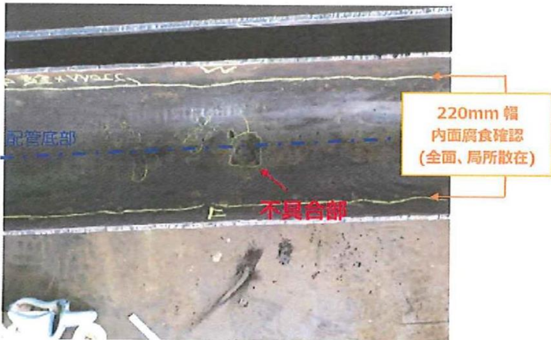
写真-1 漏洩部内面写真
