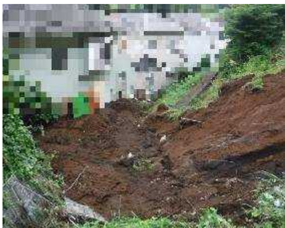
がけ崩れ発生状況
