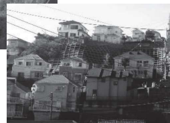
急傾斜地における宅地開発状況 (土砂災害警戒区域等の見直しが必要となる)
