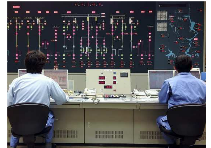
発電設備の監視制御
