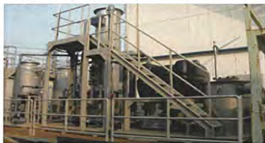
【秦野市：浄化施設】
