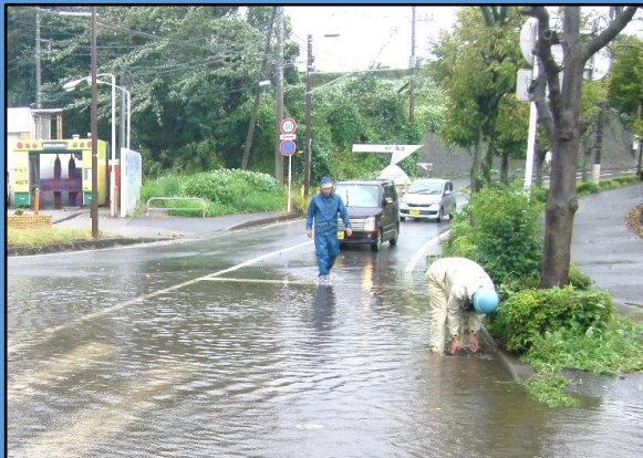
道路の排水機能を確保
