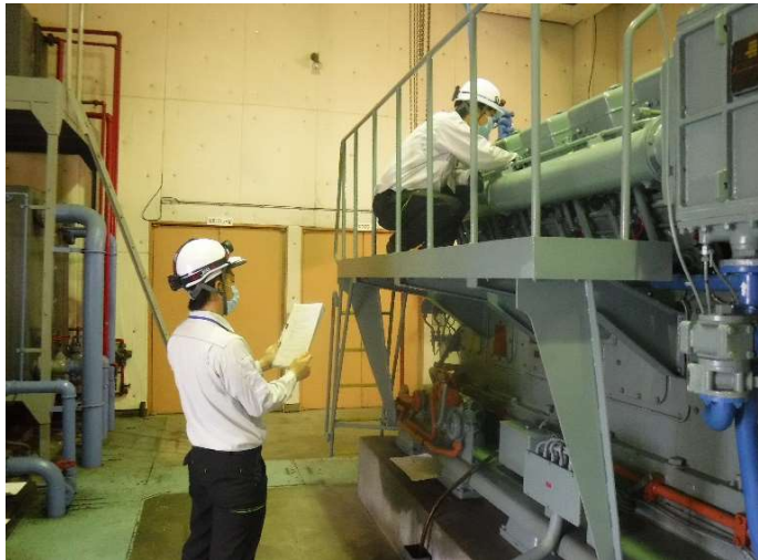
設備の点検を実施している様子
