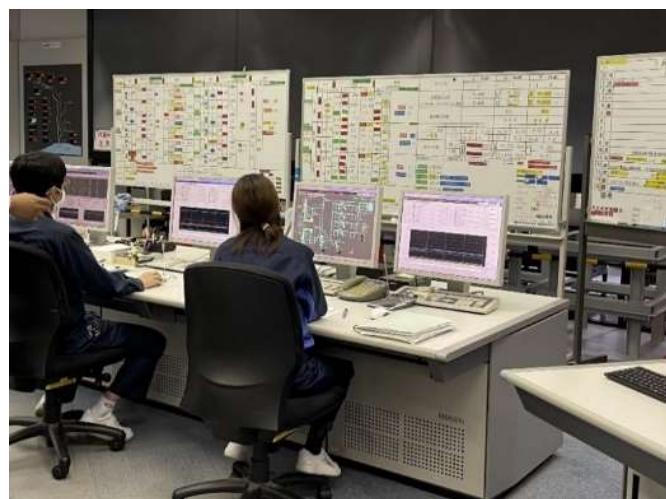
運転状況を監視している様子
