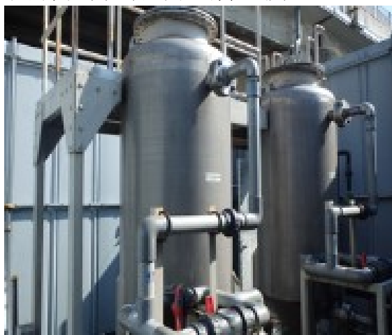
地下水汚染対策（秦野市 浄化施設）
