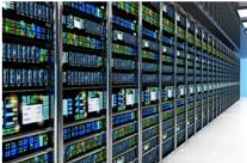
データセンター
