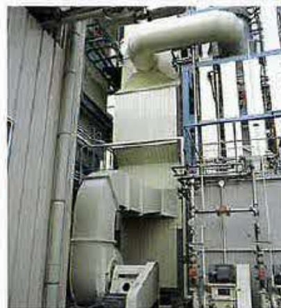
■排ガス処理設備 空気予熱器で排ガス冷却し、排ガス吸収塔で有害物質を除去します。
