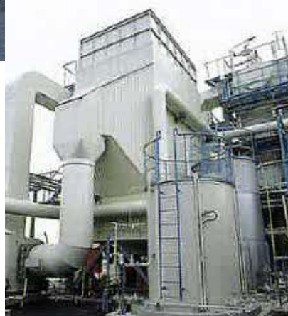
■電気集じん機 排ガス中の微細なばいじんまで集じんします。
