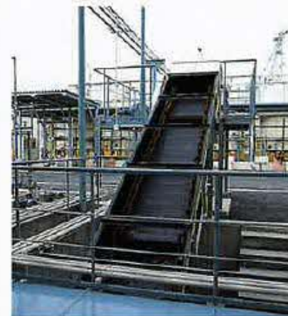
■灰出装置 焼却灰は、灰出コンベアによってコンテナへ自動搬送されます。
