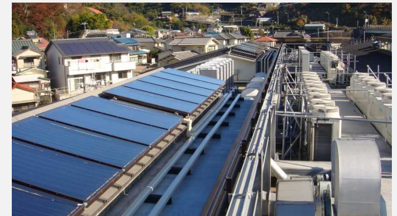
太陽熱パネルと蓄熱タンク
