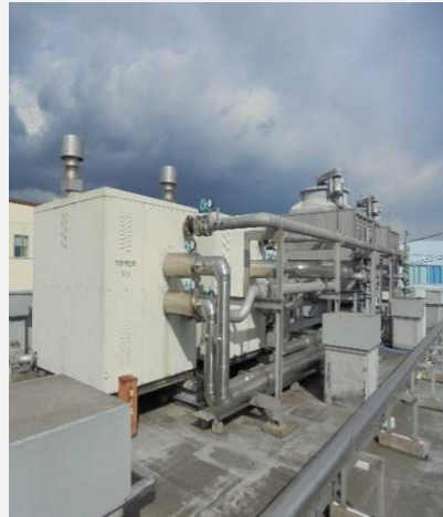
ガス炊き冷温水発生機 1995年製
