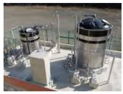
凝集剤添加設備
