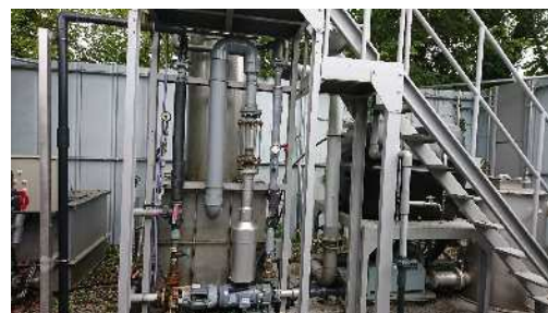
(地下水浄化設備 (秦野市))
