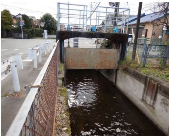
(1) 水門の遠隔自動制御化
