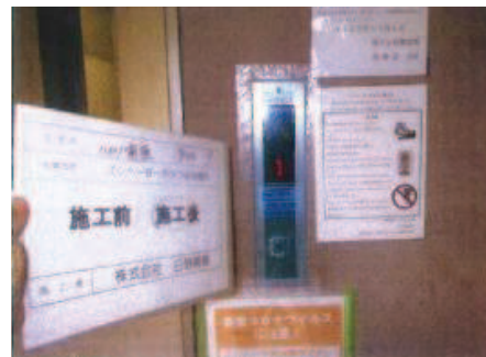
<エレベーター押しボタンの保護>
