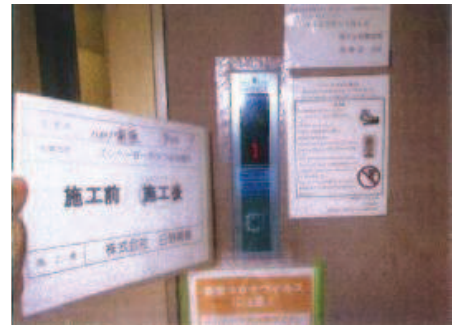
<エレベーター押しボタンの保護>
