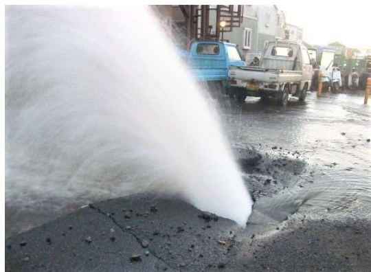
(道路面からの漏水噴出状況)
