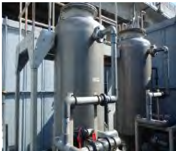
地下水汚染対策（秦野市 浄化施設）
