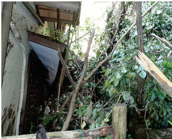
令和元年台風第15号による被害の例①
