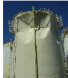
変形したタンク
