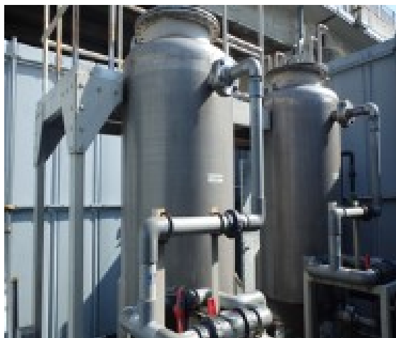
地下水汚染対策（秦野市 浄化施設）
