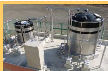
⑨相模川水系上流域対策 山梨県内の下水処理場に設置したリンを取り除くための設備を稼働した。（山梨県桂川清流センター）
