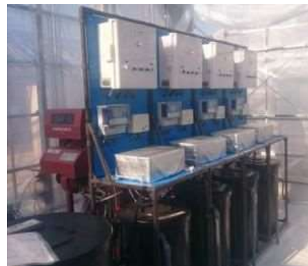
養液タンクの制御装置
