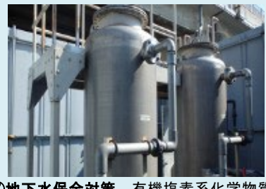
⑦地下水保全対策 有機塩素系化学物質で汚染された地下水を施設の装置に通すことにより水質浄化を図った。(秦野市)
