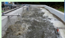
浄化槽の自動制御
