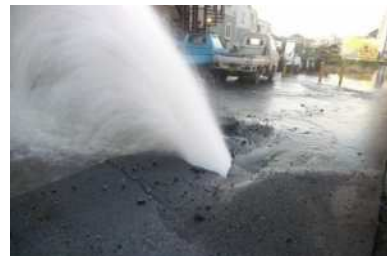
近年県営水道で発生した漏水事故
