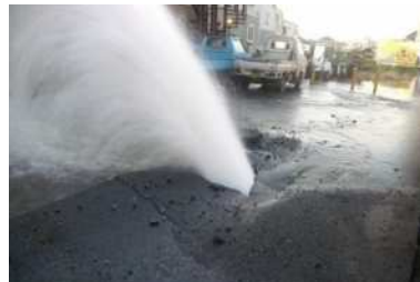
近年県営水道で発生した 漏水事故
