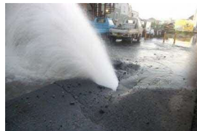
近年県営水道で発生した 漏水事故
