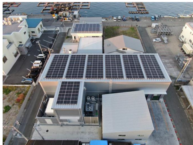
三浦市 城ヶ島水産(株)の設置事例
