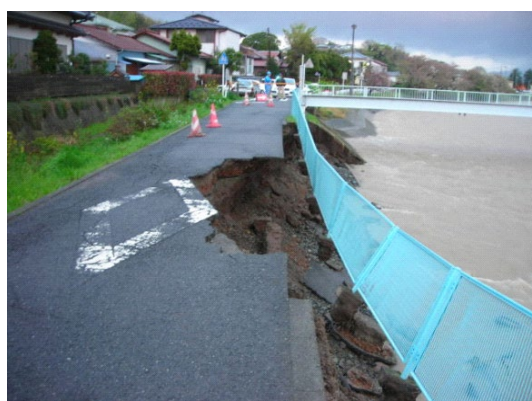
金目川中流域 平成25年4月の被害状況
