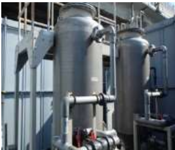
地下水汚染対策（秦野市 浄化施設）
