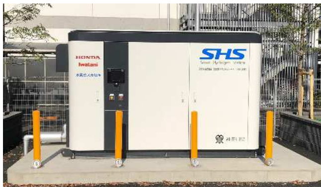
（県再エネ水素ステーション外観）
