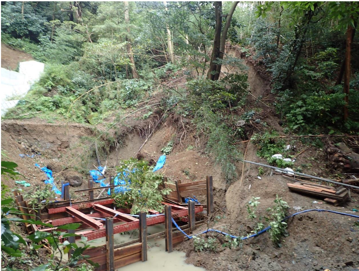
令和元年10月12日 台風19号通過後の状況 R1.10.15撮影 (左岸より土砂及び立木が滑落)
