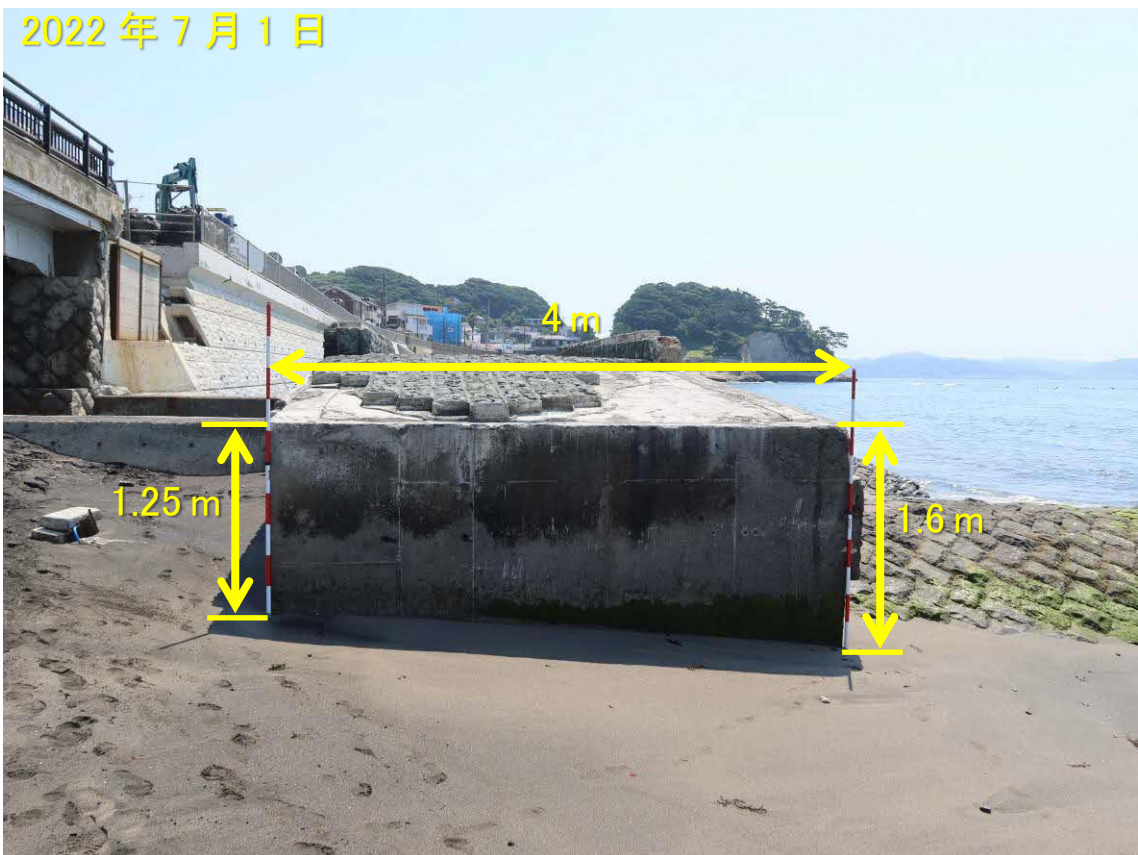
写真-4 音無川の河口に架かる歩道橋の橋台周辺状況（西端）
