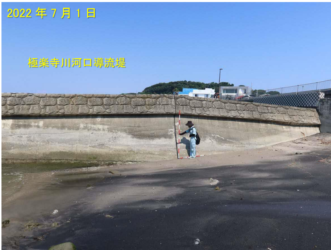
写真-1 極楽寺川河口導流堤の壁体に残された侵食痕跡
