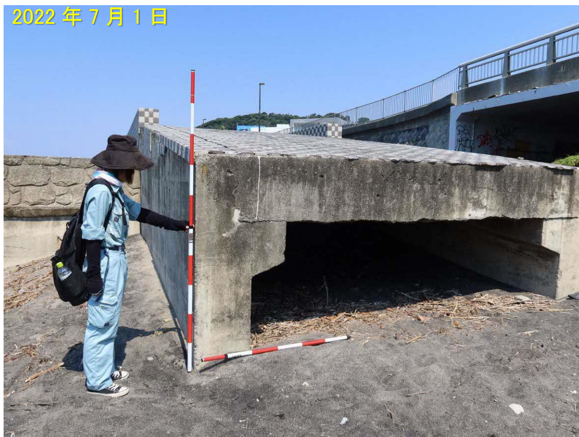
写真-2 極楽寺川の河口に架かる歩道橋の橋台周辺状況
