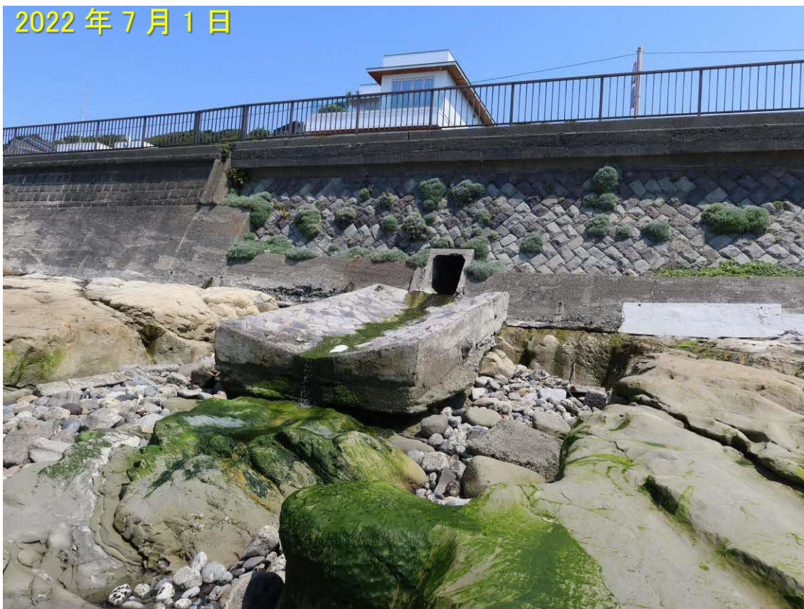
写真-5 侵食により孤立して残された排水管と水叩き
