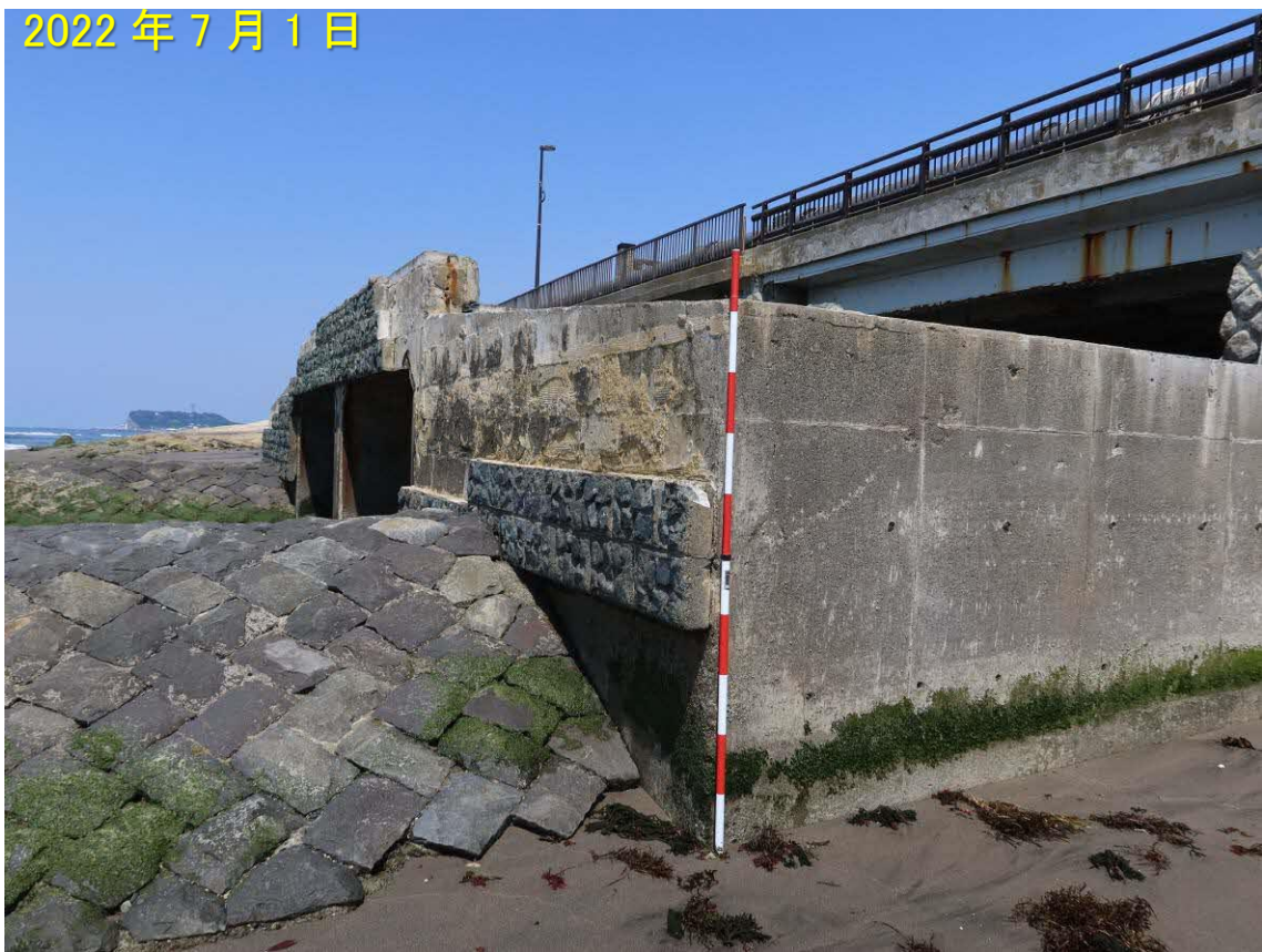
写真-3 音無川の河口に架かる歩道橋の橋台周辺状況（東端）
