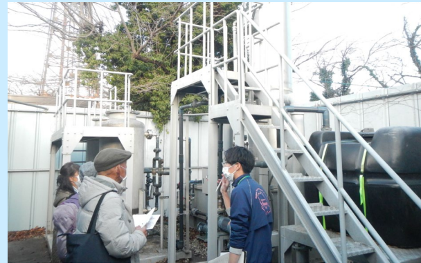
地下水保全対策事業 (秦野市)
