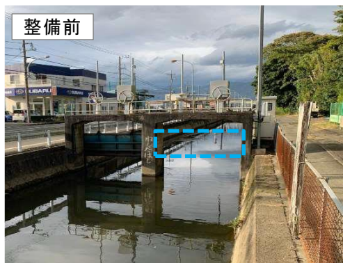
豪雨時の増水により破損した水門
