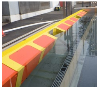
寒川浄水場の浮上式止水板
