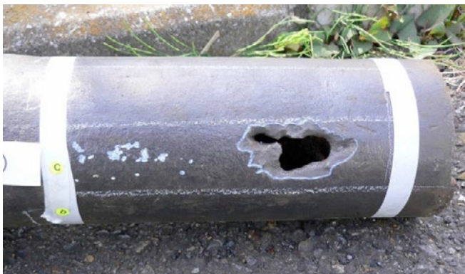
▲老朽化した水道管(1935年設置)の腐食状況
