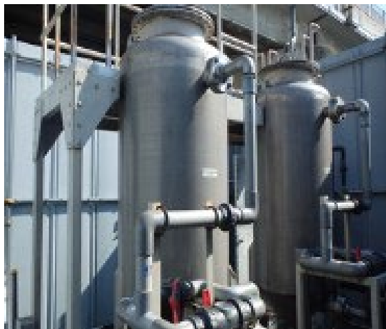
地下水汚染対策（秦野市 浄化施設）
