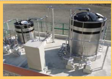
⑨相模川水系上流域対策 山梨県内の下水処理場に設置したリンを取り除くための設備を稼働した。（山梨県桂川清流センター）
