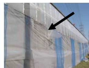
ダクトの破損(矢印) 穴が開き萎んで しまった
