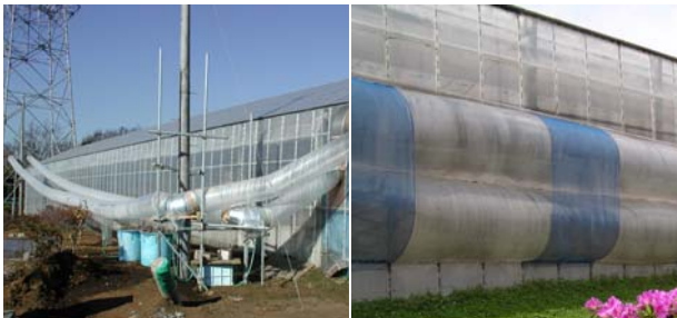
空中遊離型 壁接着型 写真1 除湿ダクトの概観
