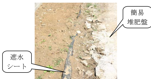
写真3 簡易堆肥盤の縁部分の欠け
