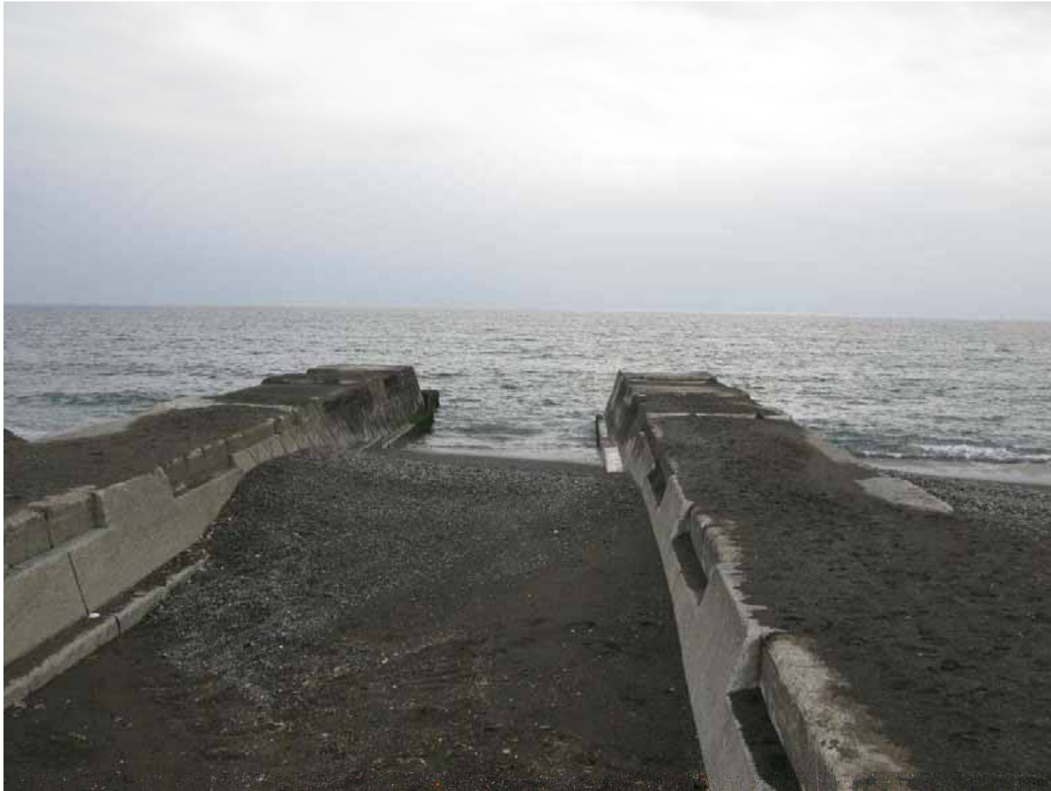
図-27 4号水路内の堆砂状況（2015年3月31日撮影）
