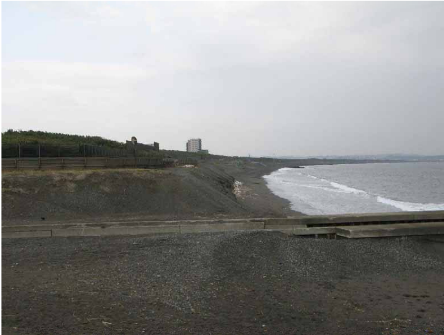
図-26 4号水路とその東側における侵食（2015年3月31日撮影）
