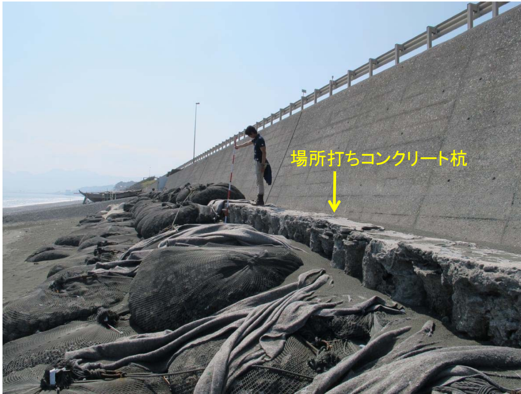
図-22 侵食されて露出した場所打ちコンクリート杭（2014年5月2日） フィルターユニットは場所打ちコンクリート杭の頭部に並べられていたが、 高波浪の作用により落下した。
