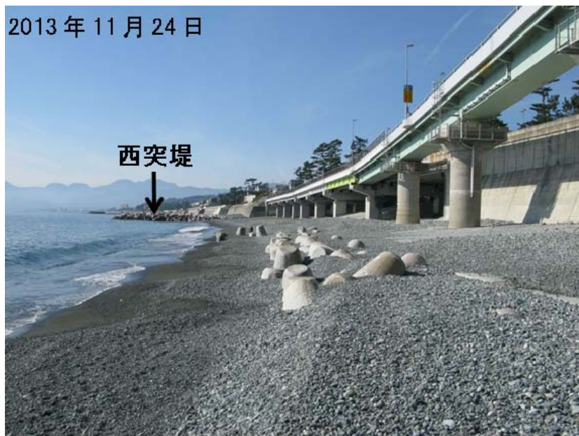
図-15 粗粒材養浜により広がった前浜と砂礫に埋まった消波工（2013年11月24日）
