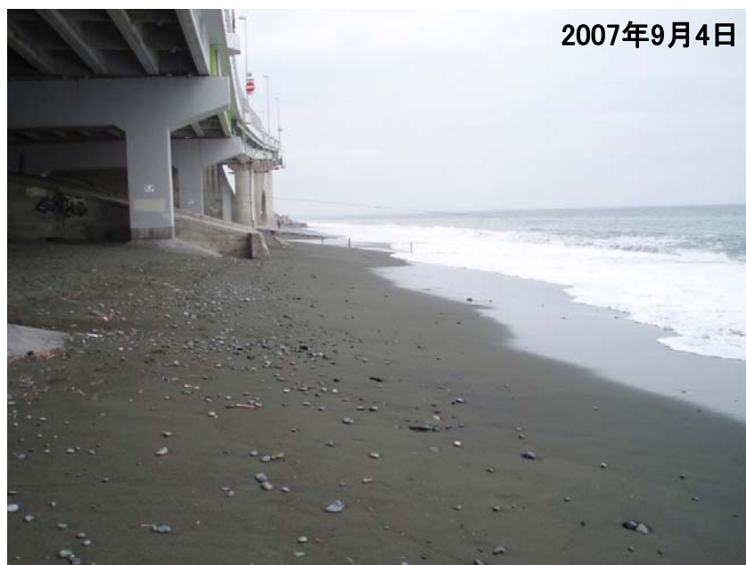
図-10 金波・銀波橋前面の被災状況(2007年9月4日)
