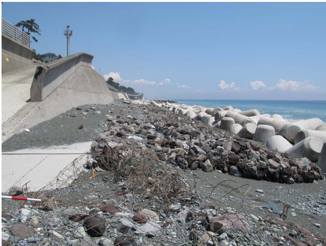
図-21 二宮海岸における破壊された鉄線籠(2012年5月2日) 海岸が汚らしくかつ危険。
