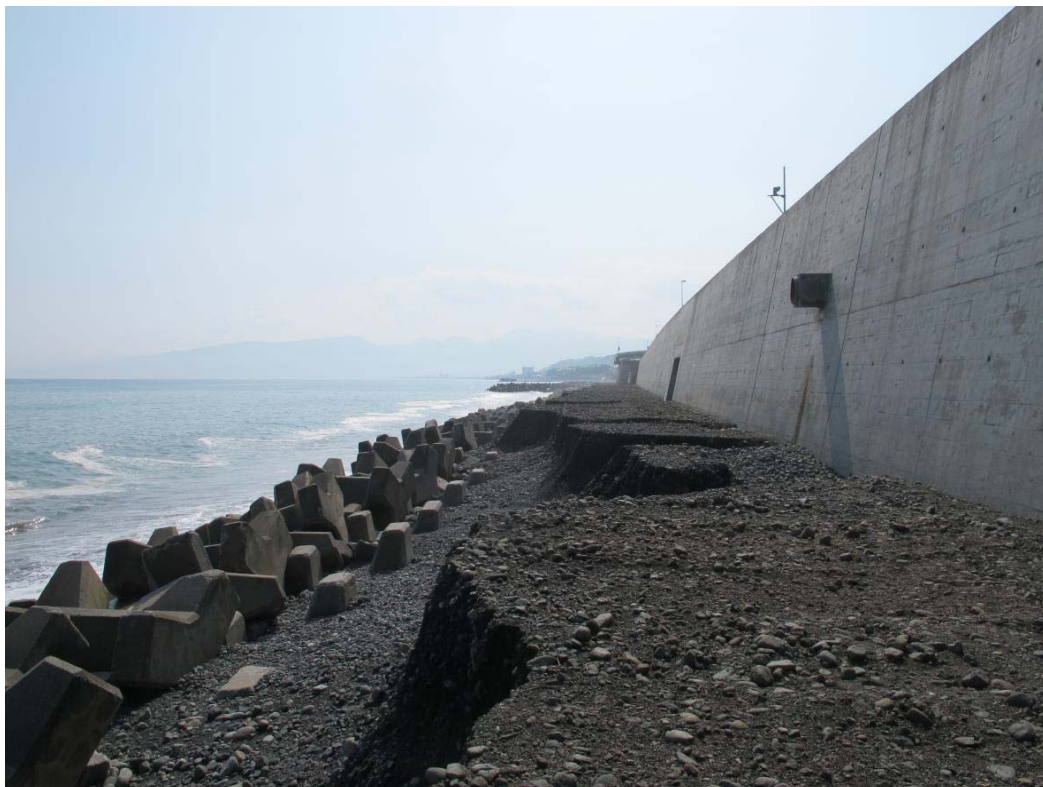
図-23 西湘バイパスの国管理区間前面での盛り土養浜（2014年5月2日） 土砂が流出し、高い浜崖が形成されている。
