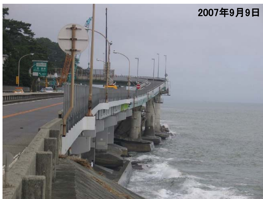
図-11 金波・銀波橋前面の被災状況 (2007年9月9日)
