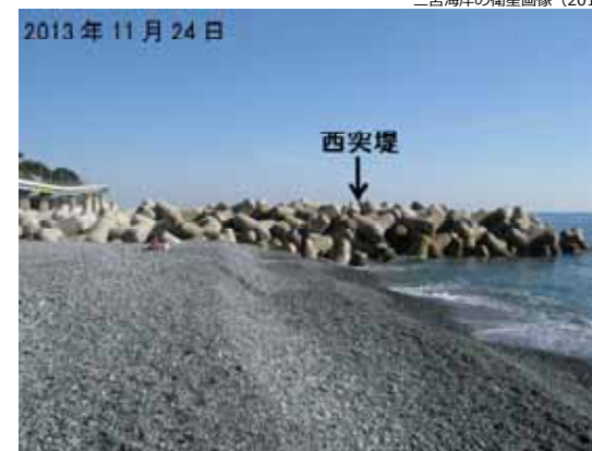
写真-16 西突堤の西側隣接部に形成された礫バーム （2013年11月24日）
