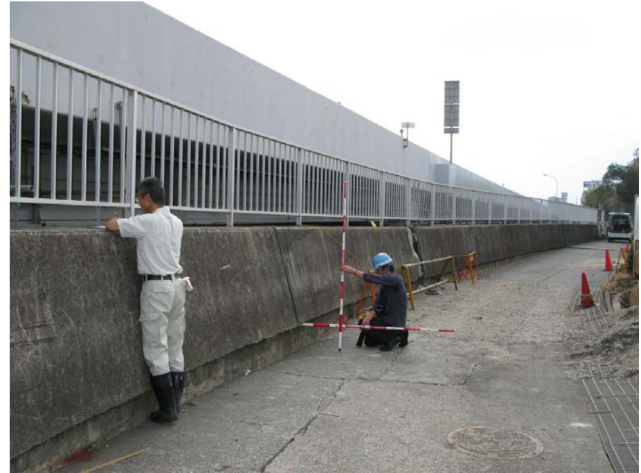
図-22 護岸が海側にはらみ出した結果，直立護岸のコンクリート天端が約0.3m沈下した。
