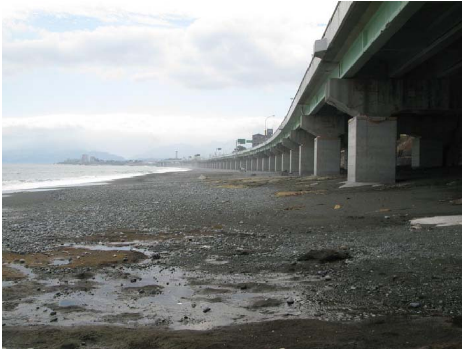
図-15 前浜に小高いバームを形成して堆積していた砂礫が消失し、基盤岩が広い区域で露出
