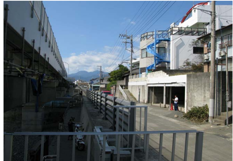
図-28 台風15号来襲時の越波被害(ブロック塀の倒壊T.P.+12m)
