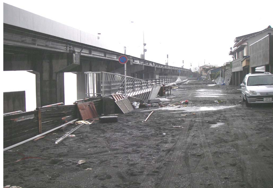
図-26 台風9号来襲後の被災状況
