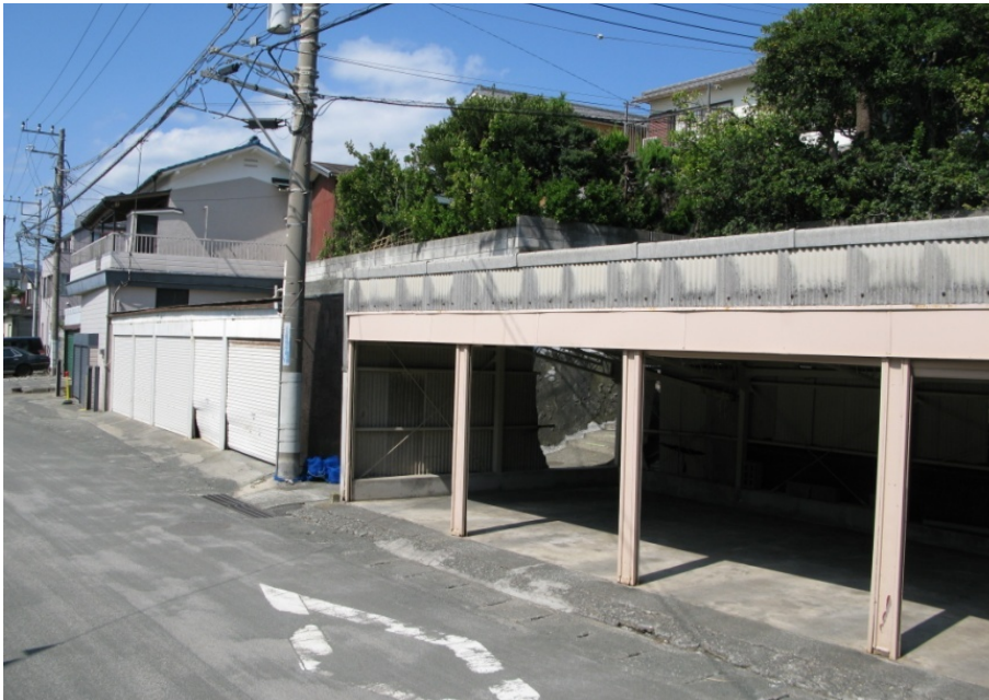
図-27 台風15号来襲時の越波被害(シャッター破損)
