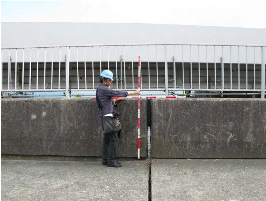
図-21 護岸の目地が約0.1m開き，隙間から海岸が見える状態
