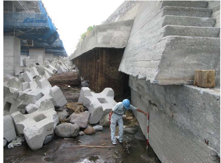
図-20 砂浜は完全に消失し、捨石と根固めブロックが散乱
