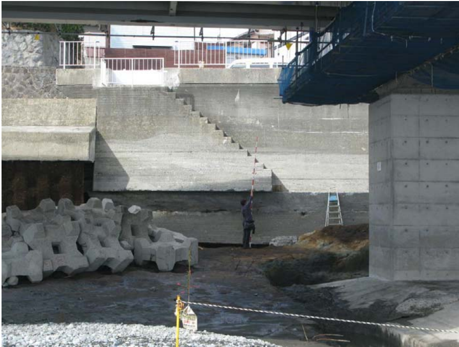
図-19 前川海岸で被災が最も著しい区間の西端付近の状況。海浜地盤高が約3.5m低下した。
