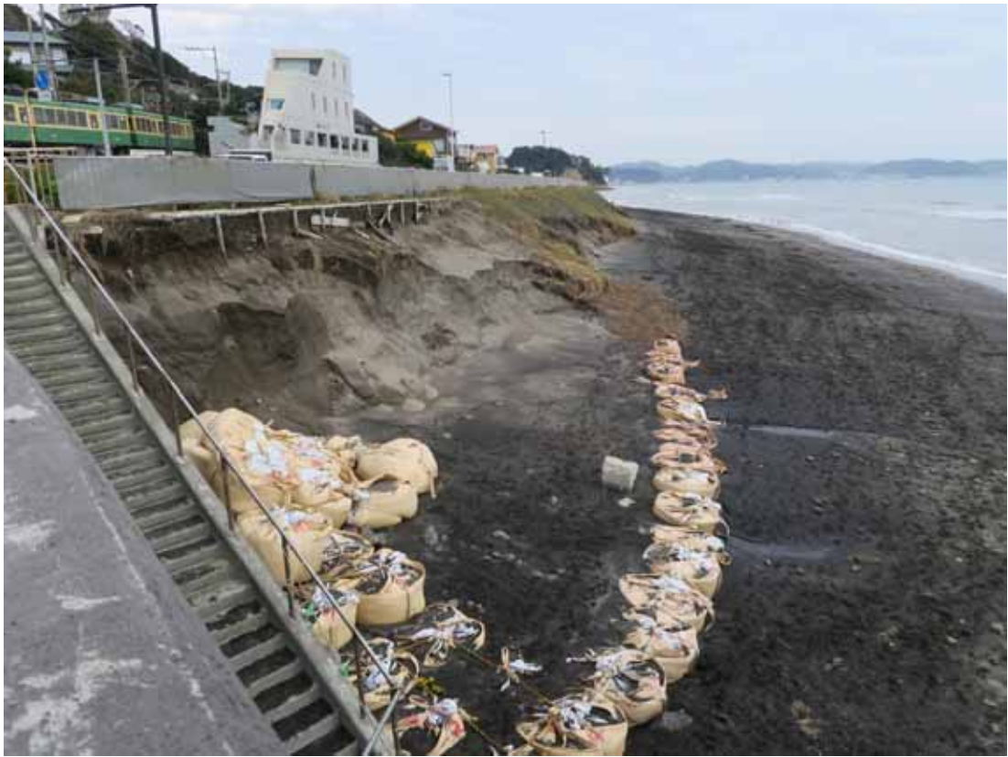
写真-3 駐車場の東端部の侵食状況
