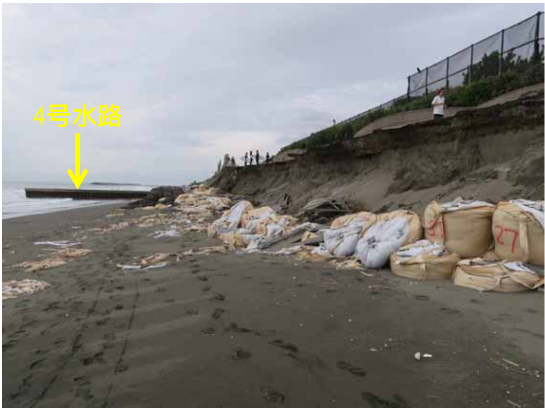
写真-10 4号水路の東側で宙ぶらりんとなった遊歩道（地点10）
