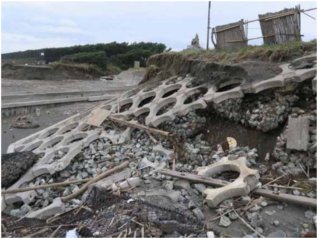
写真-7 4号水路左岸の護岸破壊状況(地点7)
