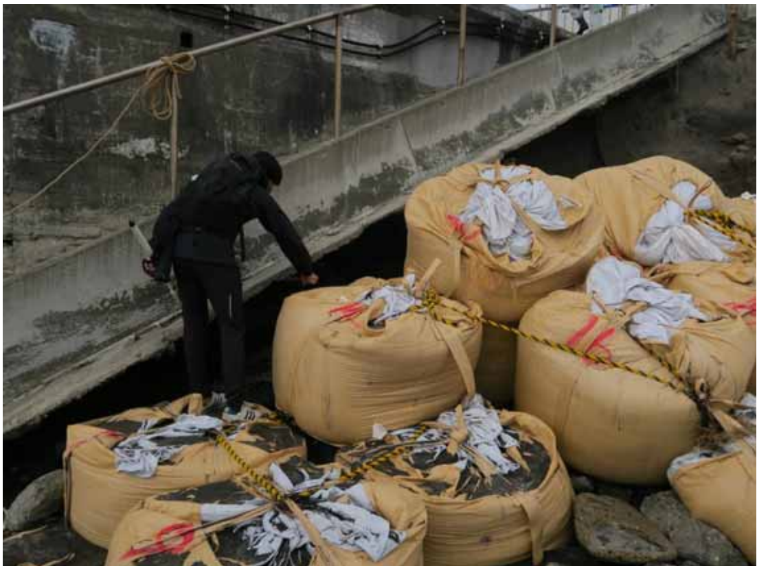
写真-4 空洞化した駐車場に隣接する階段（2mのポール全体が入る）
