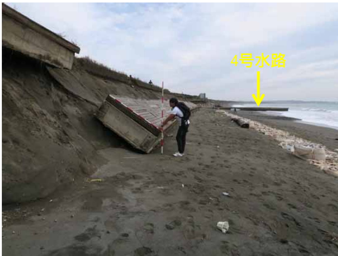
写真-5 基礎部分が侵食されたため落ち込んだボードウォーク（地点5）
