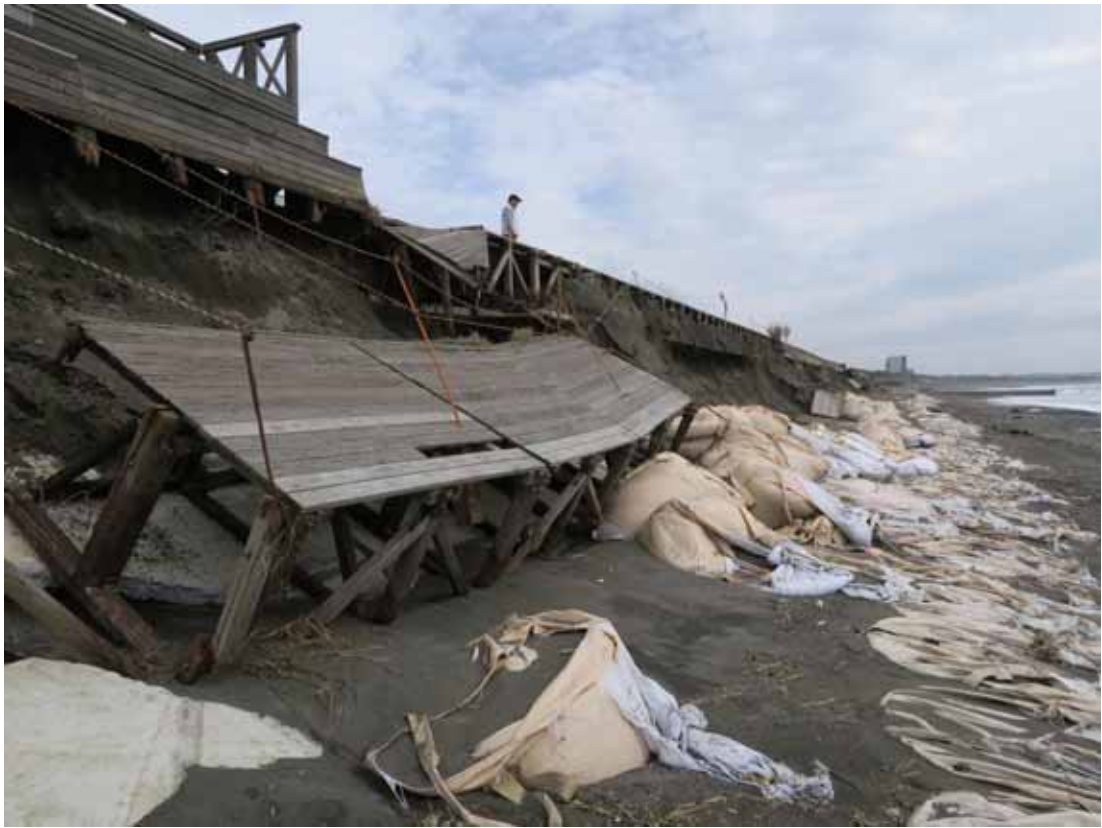
写真-3 遊歩道上にあったボードウォークの転落（地点3）
