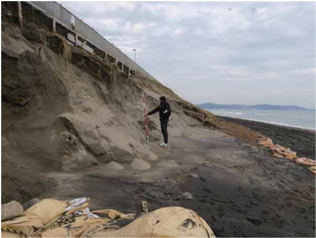
写真-5 階段の東側隣接部にできた比高約3 mの浜崖
