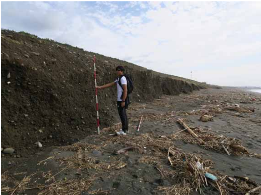
写真-9 柳島消波堤の東端から800 m地点での比高の低下した浜崖
