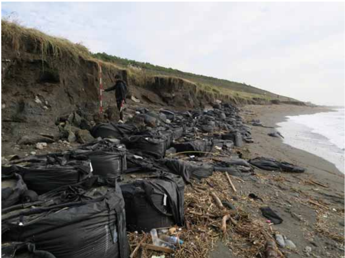
写真-7 基礎として埋められていた大型土嚢の露出とその背後に形成された比高約2 mの浜崖
