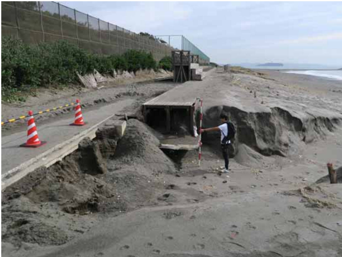
写真-10 遊歩道からの戻り流れによる侵食
