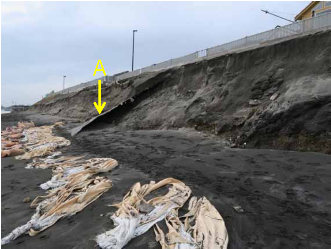
写真-9 斜面防護のために斜面を覆って簡易的に張られたコンクリートの残骸
