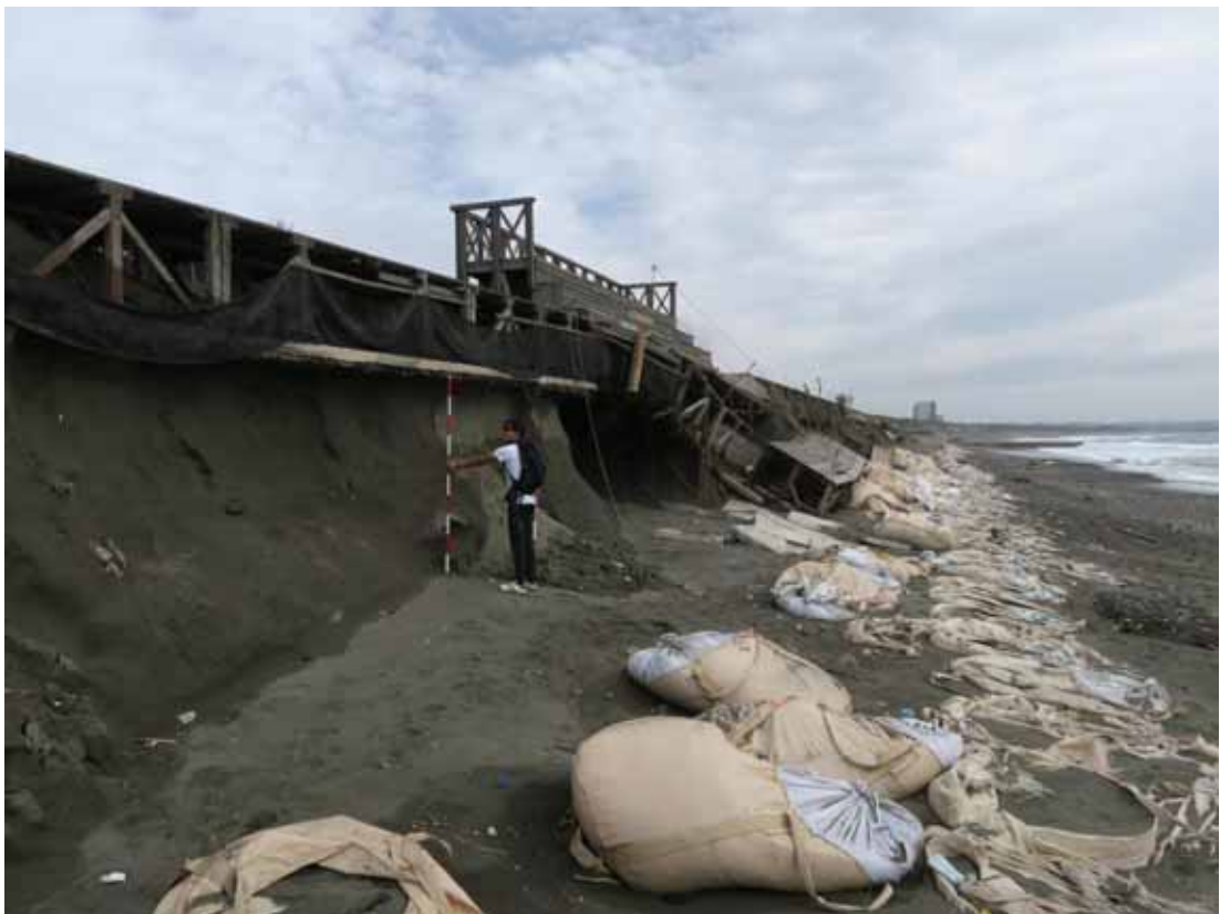
写真-2 侵食されて宙ぶらりんになったボードウォークの下部 (地点2)
