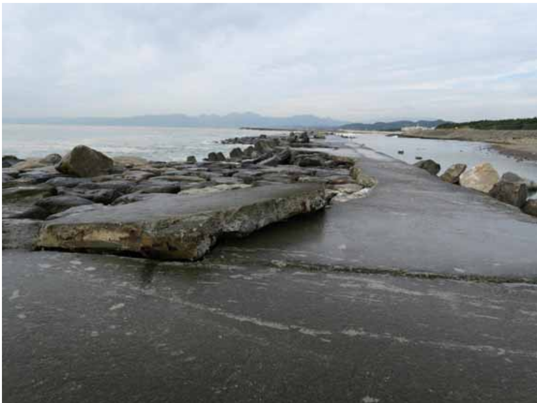
写真-1 波の作用により剥がされた消波堤の天端コンクリート
