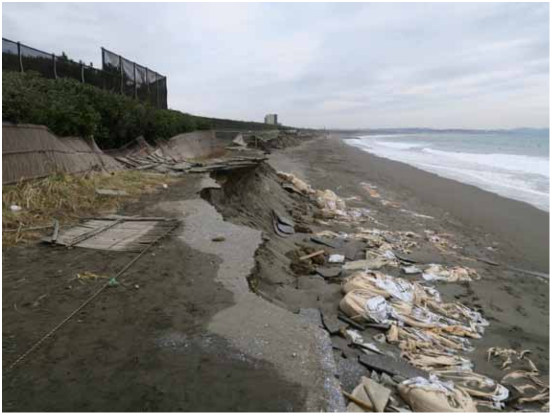
写真-9 4号水路の東側隣接部で切れた遊歩道（地点9）
