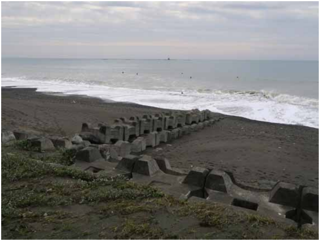
写真-8 ブロックが大きく露出した突堤の付け根付近
