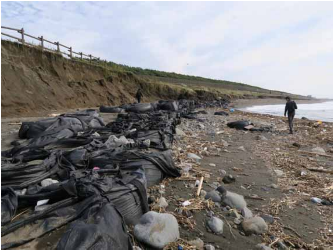
写真-6 盛り土の基礎として使われていた大型土嚢の露出
