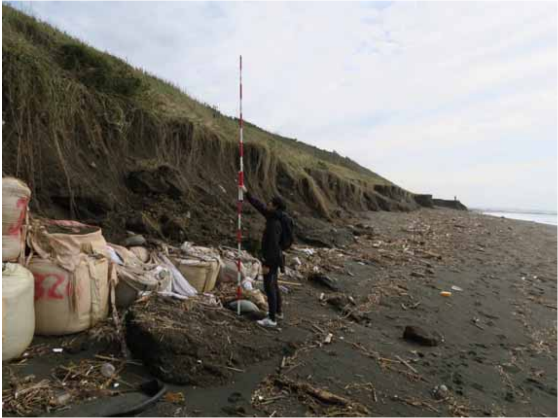
写真-8 比高2.7mの浜崖はできたものの基礎用の大型土嚢は一部現れたのみの地点8の状況
