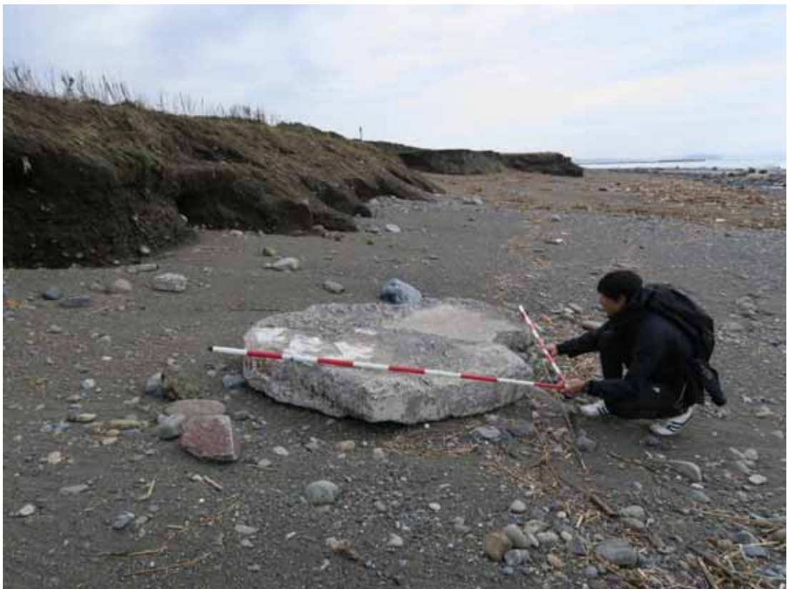
写真-3 陸側深く運ばれた2 m角の天端被覆コンクリート
