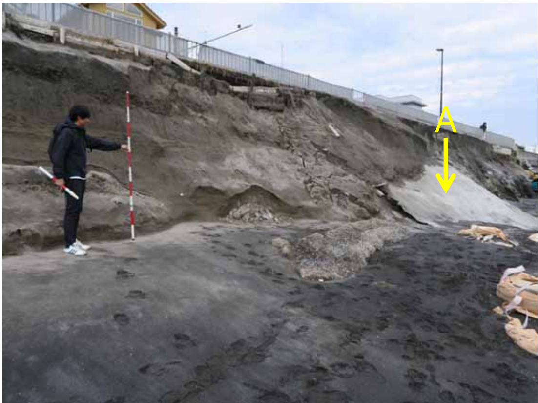
写真-8 比高3 m以上に及んだ浜崖と壊れた国道134号線の歩道
