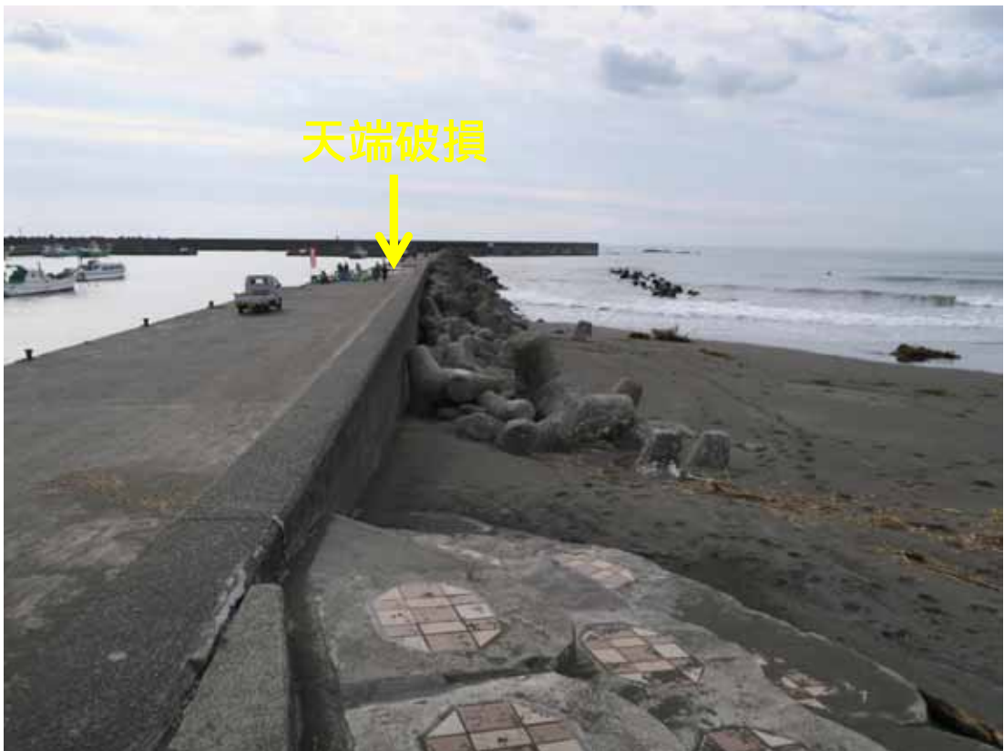
写真-13 越波により天端が破損した茅ヶ崎漁港の西防波堤
