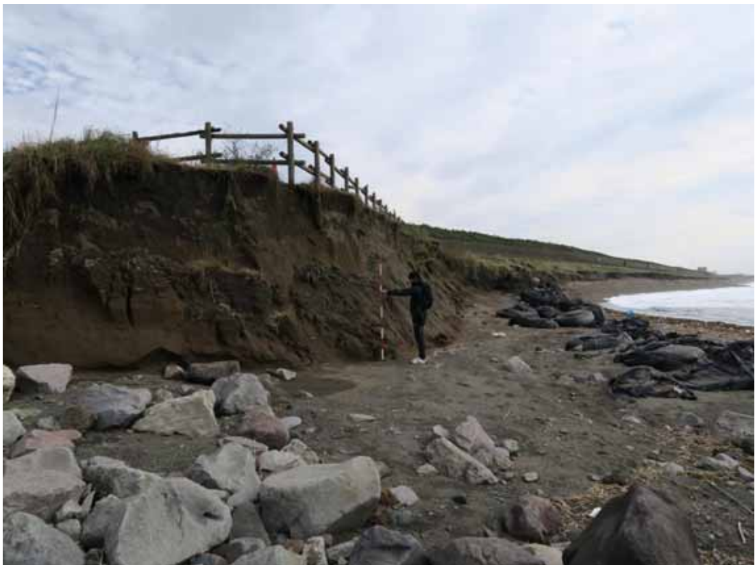
写真-5 盛り土端部が激しく侵食されてできた比高2.9 mの浜崖
